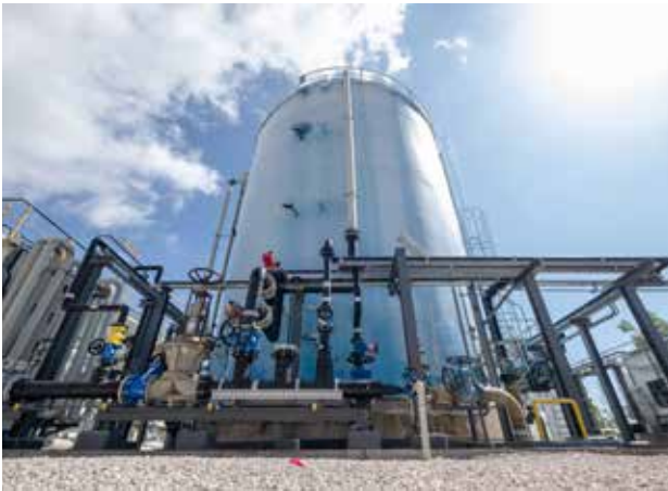
Las instalaciones para el tratamiento biológico de aguas del centro de Tarragona fueron mejoradas en 2017.
